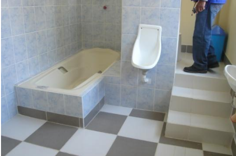
Trocken-Urinal und Komposttoilette in einem Bad in Achocalla
